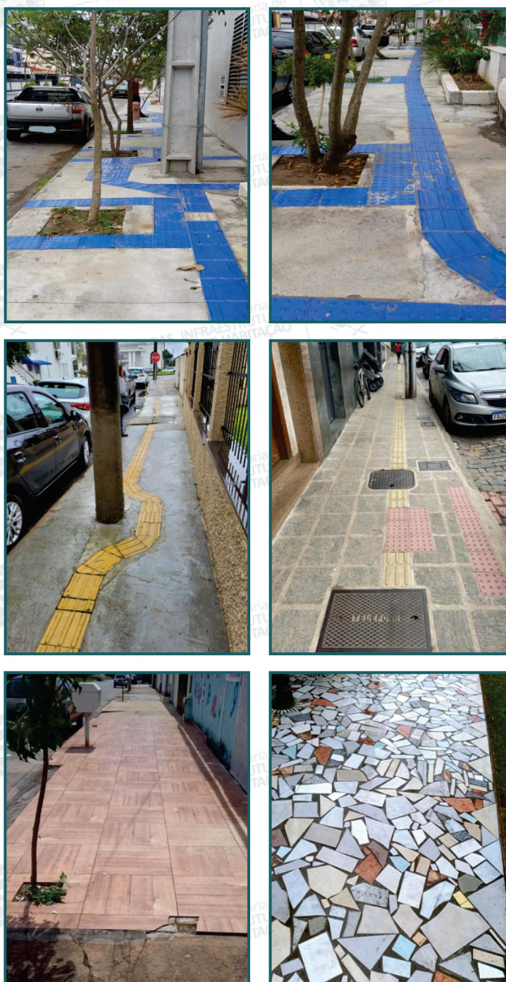
Figura 38. Calçada Executadas de Maneira Irregular
